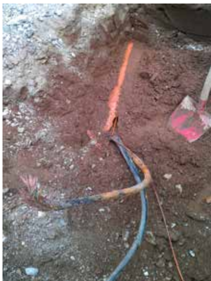
>> Kabelschaden in der Erlanger Schalkstraße <<
