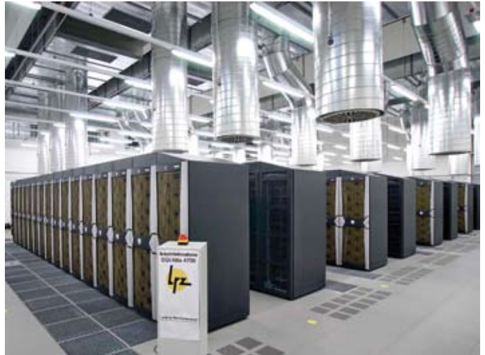
Der Höchstleistungsrechner Bayern II, kurz HLRB II im Neubau des Leibniz-Rechenzentrums in Garching bei München. Das System von Silicon Graphics auf Basis der Altix 4700 Plattform wurde am 21. Juli 2006 in Betrieb genommen (Quelle LRZ).
