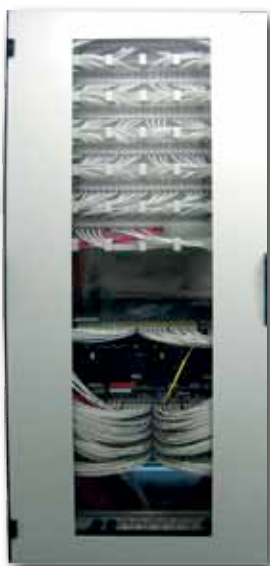
>> Strukturierte Etagenverkabelung eines Verteilerschranks in einem der zehn Technikräume im NMI <<
