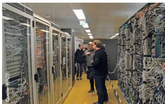
Quelle: RRZE Server- und Netztechnik im sonst für die Öffentlichkeit nicht zugänglichen Serverraum des RRZE.
