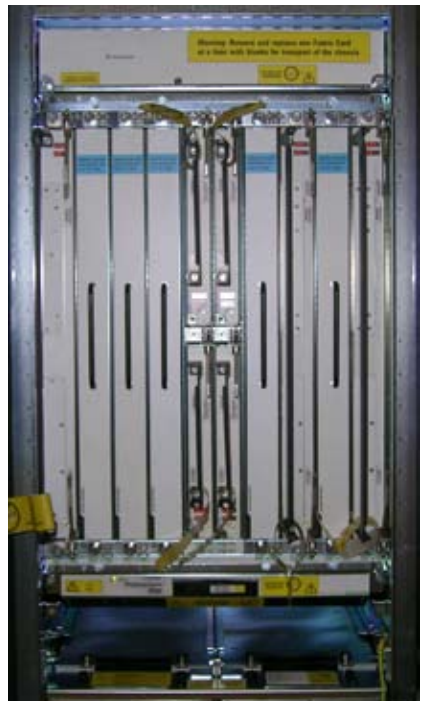
Abb. 14: Das Herzstück des Supercores: Ein Hochleistungsrouter mit einer Leistung von 640 Gigabyte pro Sekunde.
