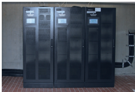
>> Neue USV-Anlage mit drei Schränken ...
