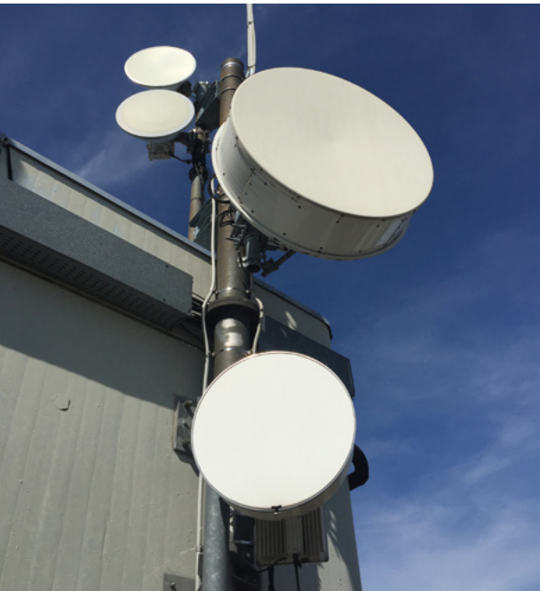
Abb. 30 Richtfunkantennen auf dem Dach der Informatik. Die grösste „Schüssel“ hat einen Durchmesser von 1,60m.
