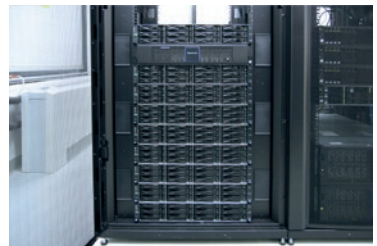
Backup-Roboter (oben), Backup-Speicher
