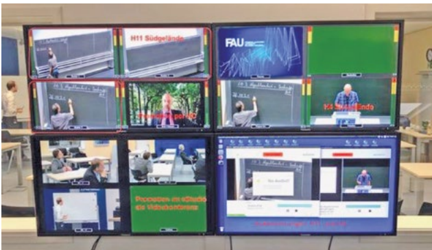
Blick auf die Monitore der E-Regie über die parallel stattfindende Veranstaltungen verfolgt werden. Hier wird die Vielgestaltigkeit in einer gemeinsamen Regie sichtbar.
