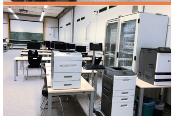
Neu ausgestatteter CIP-Pool 1 (Raum 0.215) im Neubau des Gebäudes neben der Cafeteria in der Langen Gasse 20 am Fachbereich Wirtschafts- und Sozialwissenschaften
